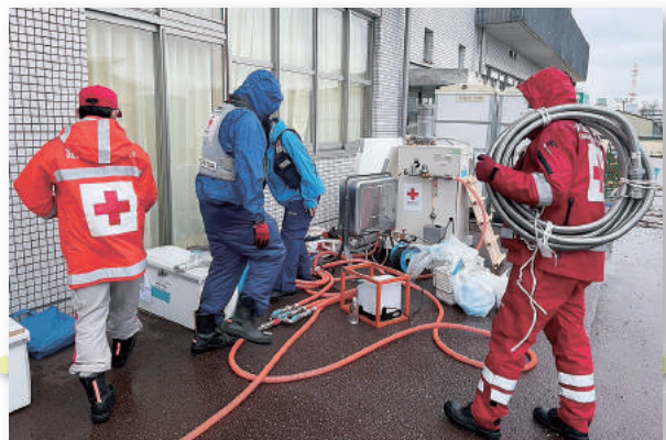
▶給水衛生支援チームによるシャワーの設置
