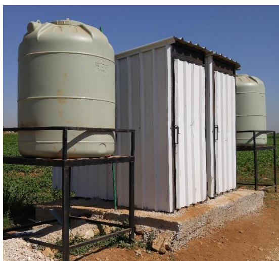
スタンド（台）の上に設置された1,000Lタンクと、その横に設置されたトイレ
