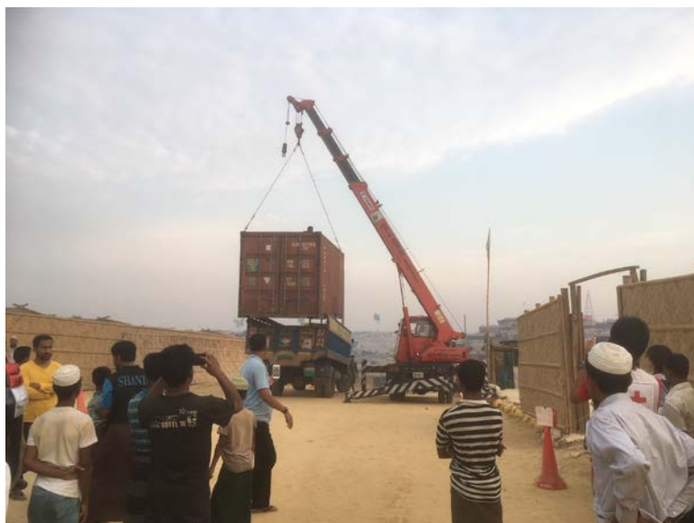
サイクロン対応のための資機材を保管するコンテナの設置
