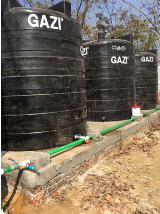
現在、建設中の給水タンク、10 t タンク×3 基礎工事は横 9m、幅 3m、高さ 0.4m でレンガとセメントで作製
