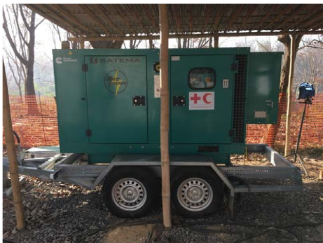
トレーラーに載せられた大型発電機
