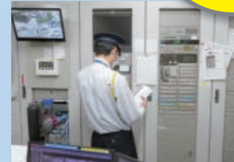
防災センター
