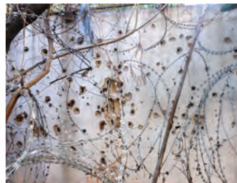
銃弾の残る小学校の壁
