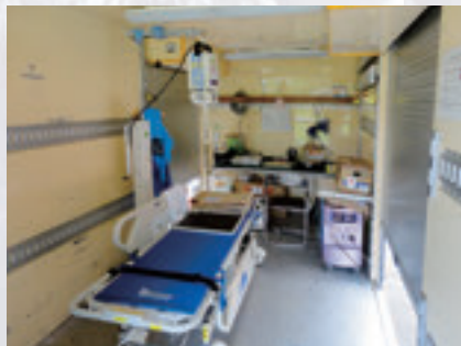
レントゲン室(コンテナ)内部
