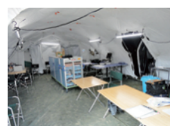
dERU外来棟内／ 照明や空調も自家発電機で自立
