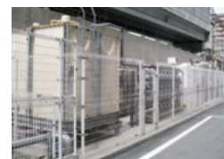
井水システム／日常点検を経て、普段から井水を使用
