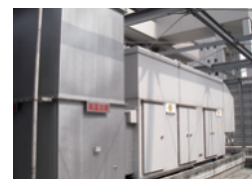
非常用発電機／停電後約40秒以内で起動
