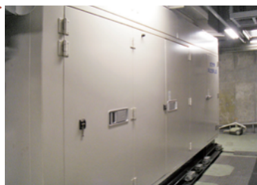
コージェネレーションシステム
