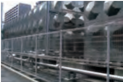
▲院内プラント
