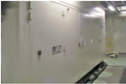
▲自家発電装置
